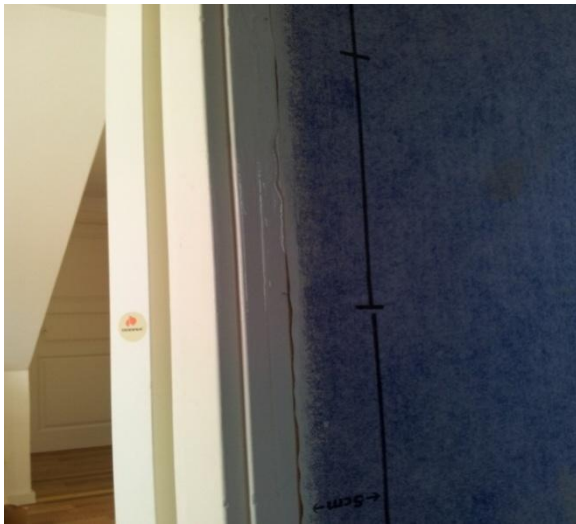
Bild 5. Reovering. Ej tillräcklig anslutning av tätskikt mot dörrkarm (våtzon 1). Tätskiktet är vågigt och sluter inte tätt mot dörrkarm. (Foto: Johan Frid)
