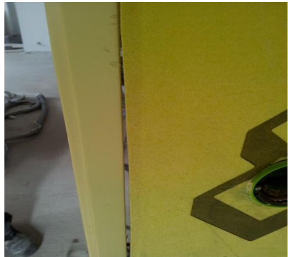
Bild 6. Nybyggnation. Ilagning samt anslutning av tätskikt mellan dörrkarm och vägg saknas. (våtzon 2). (Foto: David Wormö)
